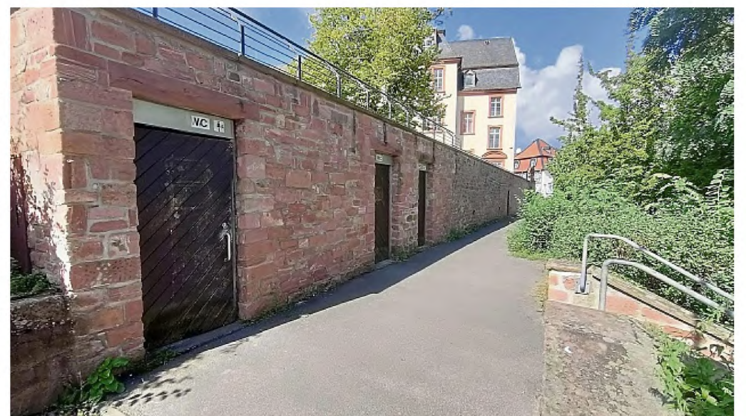
Für 220000 Euro sollen die überwiegend kaputten Toiletten unterhalb des ehemaligen Bubenschulhofs modernisiert werden.
