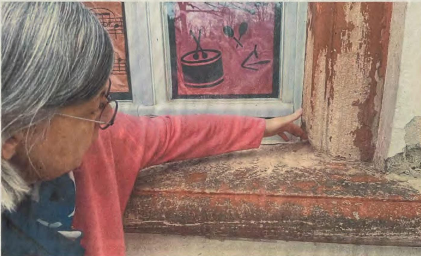
Katja Teubner zeigt die Schäden am Sandstein der Fensterbänke. Dort dringt Wasser in die Außenwand.
